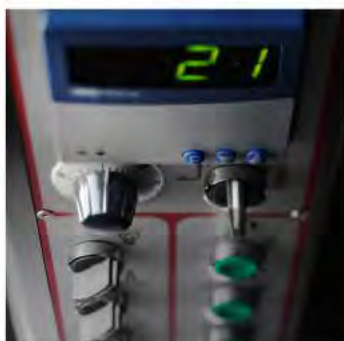
Электромеханическая панель управления
